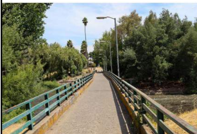
Figura 2. Estado actual puente peatonal 2 poniente.
